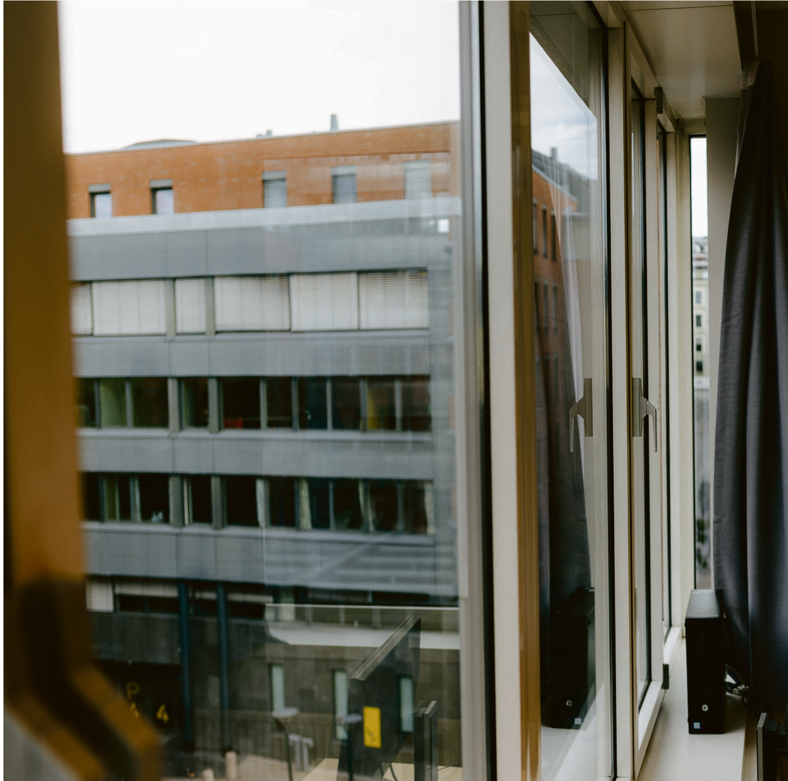
Langt ned: Oslomet bekrefter at flere av vinduene mangler sikring.
